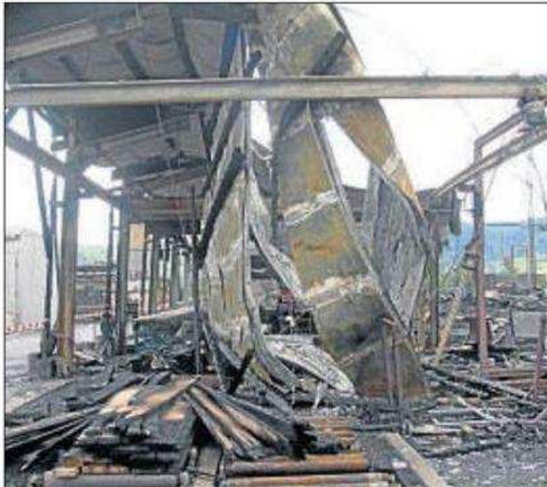
Rückblende: Die Halle, in der Hölzer gelagert wurden, brannte im August 2010 bis auf die Grundmauern nieder. Archivfoto:Maß
